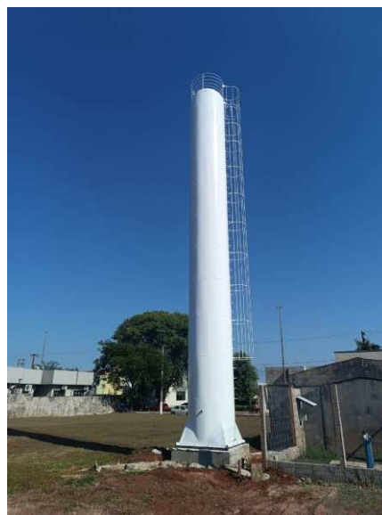
Foto: Caixa D'Água instalada
