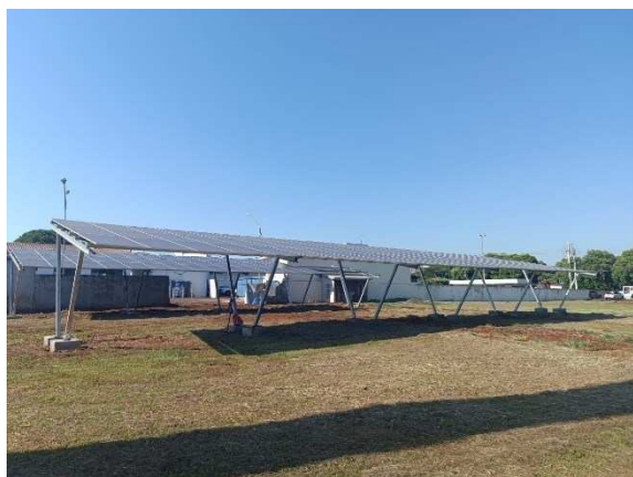
FOTO: Carpot com placas solares – terreno da ABM
