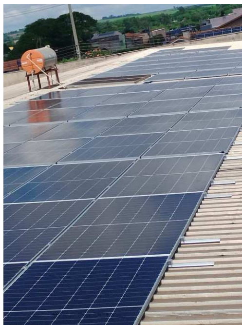
FOTO: Placas solares instaladas – telhado do Pronto Atendimento
