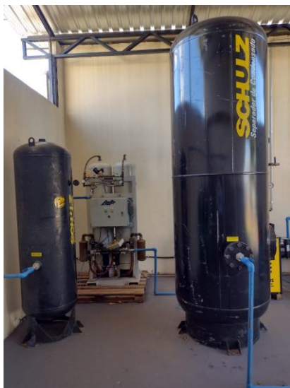
Usina de Oxigênio
