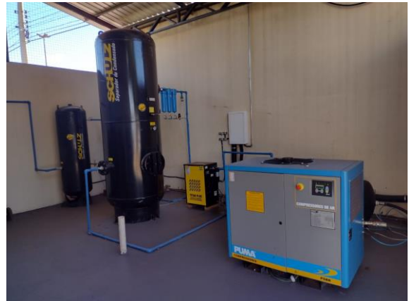
Usina de Oxigênio
