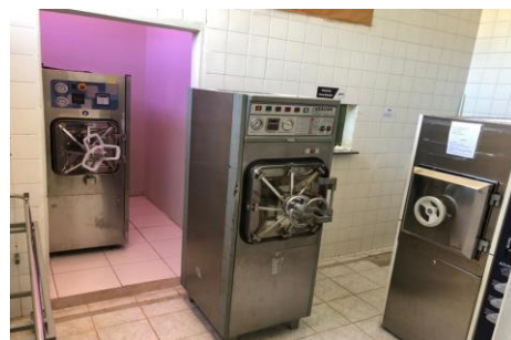
Autoclaves instaladas e em funcionamento (03)
