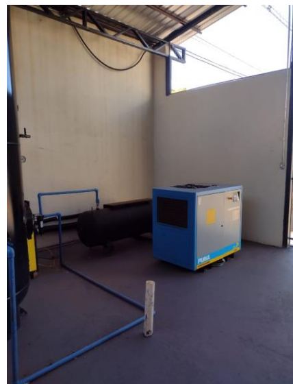
Compressor Usina de Oxigênio
